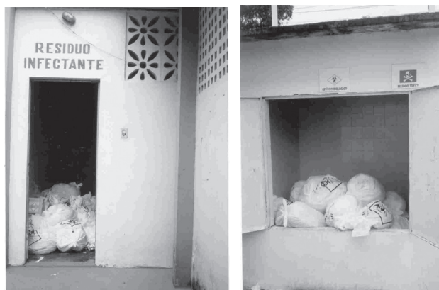
Figura nº 11 – Lixeira aberta e excesso de RSS acumulado
